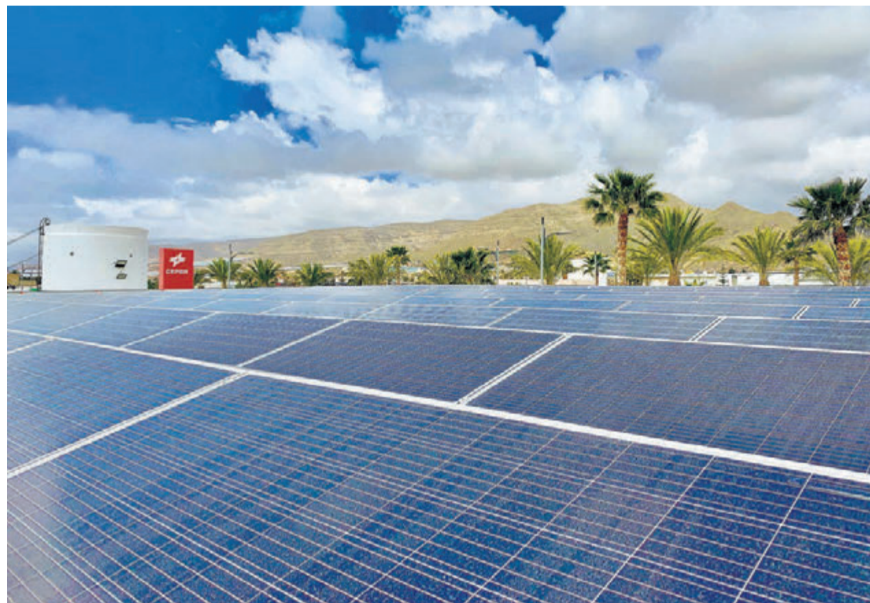
VISTA AÉREA del nuevo proyecto de autoconsumo fotovoltaico instalado en Aguadulce.
